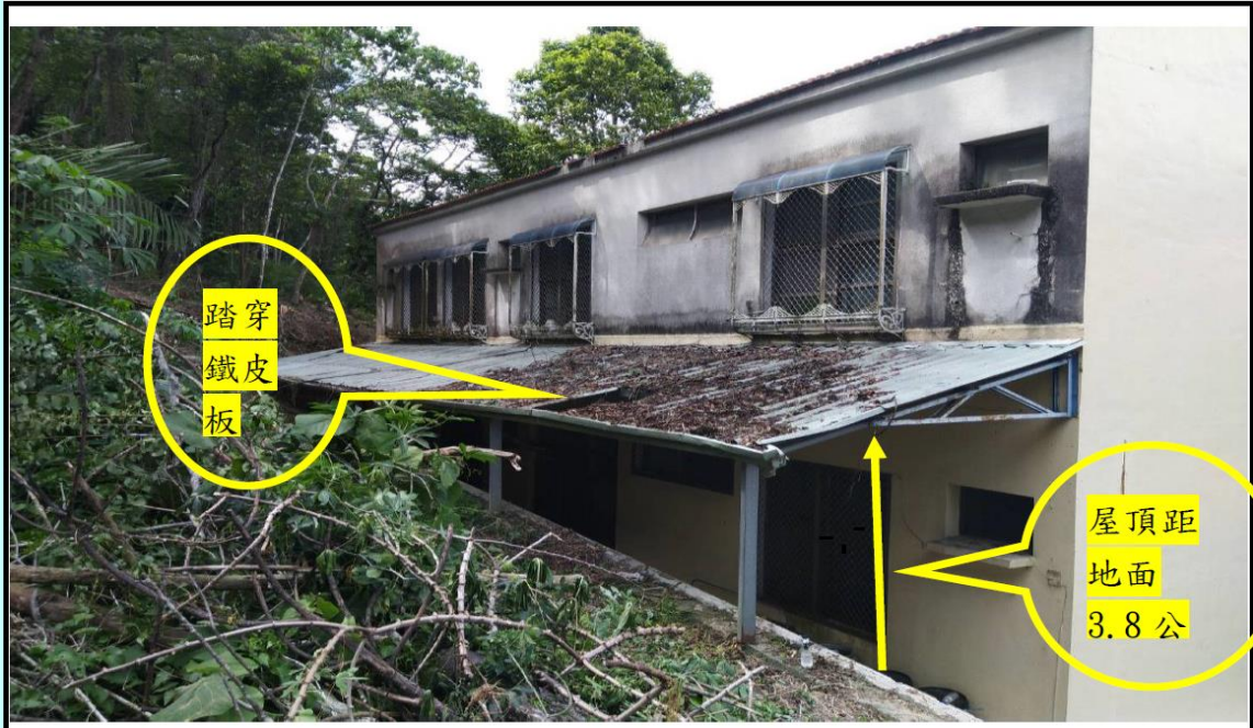
照片 1 屋頂（未設置護欄未設置安全母索及未設寬 30 公分以上踏板）踏穿鐵皮板
