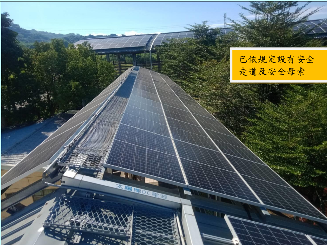
附照 說明：清洗已告一段落欲休息時，洪○○解開安全帶鉤環並沿著 40 公分之安全通道 往回走，於行走時踩到太陽能板（剛清洗完為溼滑狀態）滑倒並墜落至地面
