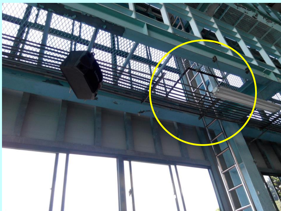
二樓平台鄰近固定梯之開口部份(離一樓地板高度約4.7公尺)， 未有適當強度之圍欄、握把、覆蓋等防護措施， 亦未採用安全網等措施
